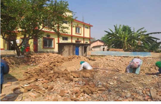
वडा नं ३ मा जिर्ण भवन ब्यबस्थापन
