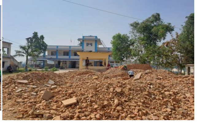
वडा नं ४ मा जिर्ण भवन ब्यबस्थापन
